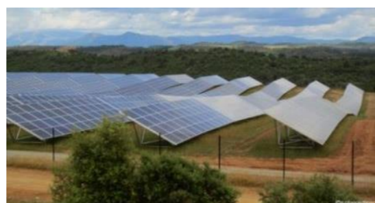
Photographie 1 : Exemple d'installation photovoltaïque au sol
